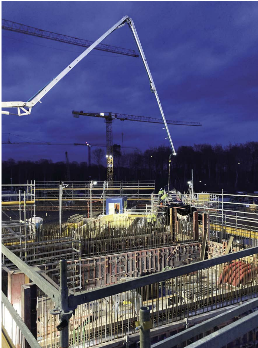
Bild1: Der Einsatz von Selbstverdichtendem Beton war stellenweise wegen der sehr dichten Bewehrung erforderlich.
