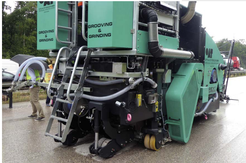
Bild 3: Fräse mit Diamant-Trennscheiben zur Wiederherstellung von Ebenheit, Griffigkeit und Lärm mindernden Eigenschaften
